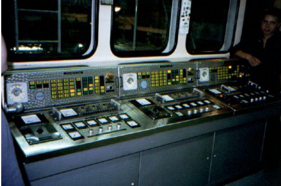
Maschinenkontrollraum der MS Anton Tschechov
